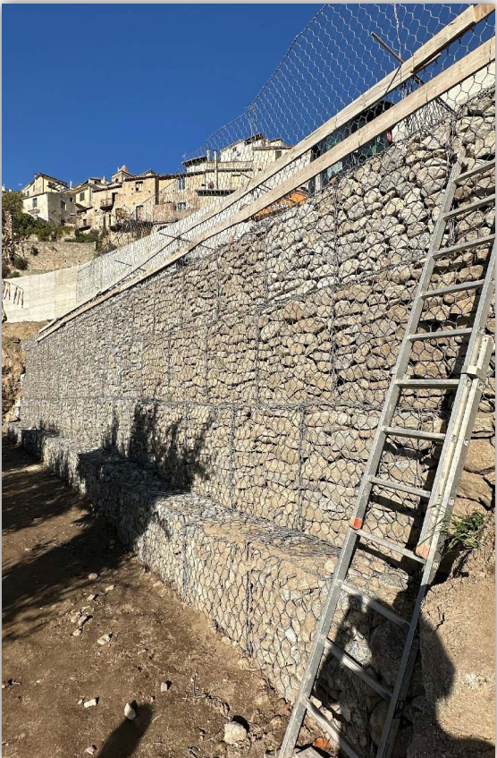
Barriere paramassi, fermaneve e simili Comune di Petrizzi - Lavori di messa in sicurezza dei versanti
