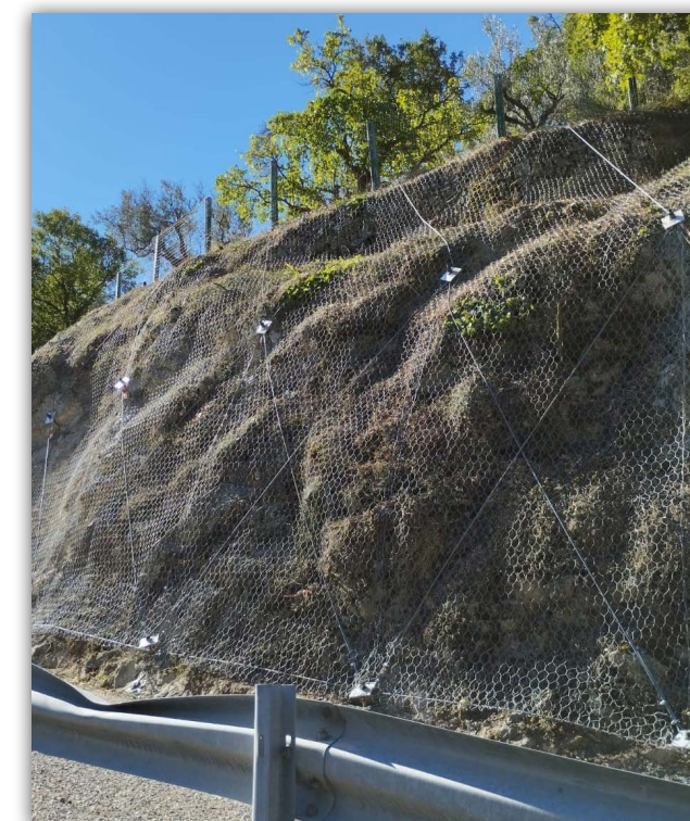
Barriere paramassi, fermaneve e simili ANAS Viabilità - NSA 571 ex SP2 Reggio Calabria
