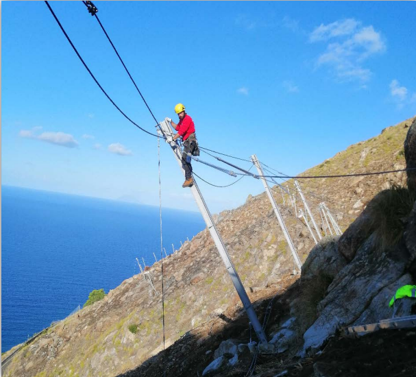
Barriere paramassi, fermaneve e simili ANAS Viabilità - SP23
