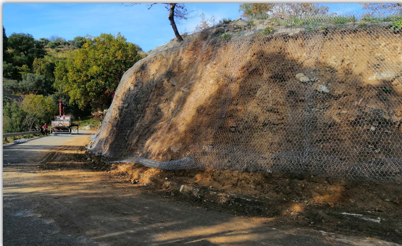
Barriere paramassi, fermaneve e simili ANAS Viabilità - NSA 571 ex SP2 Reggio Calabria
