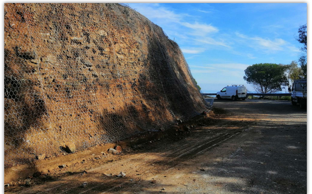
Barriere paramassi, fermaneve e simili ANAS Viabilità - NSA 571 ex SP2 Reggio Calabria
