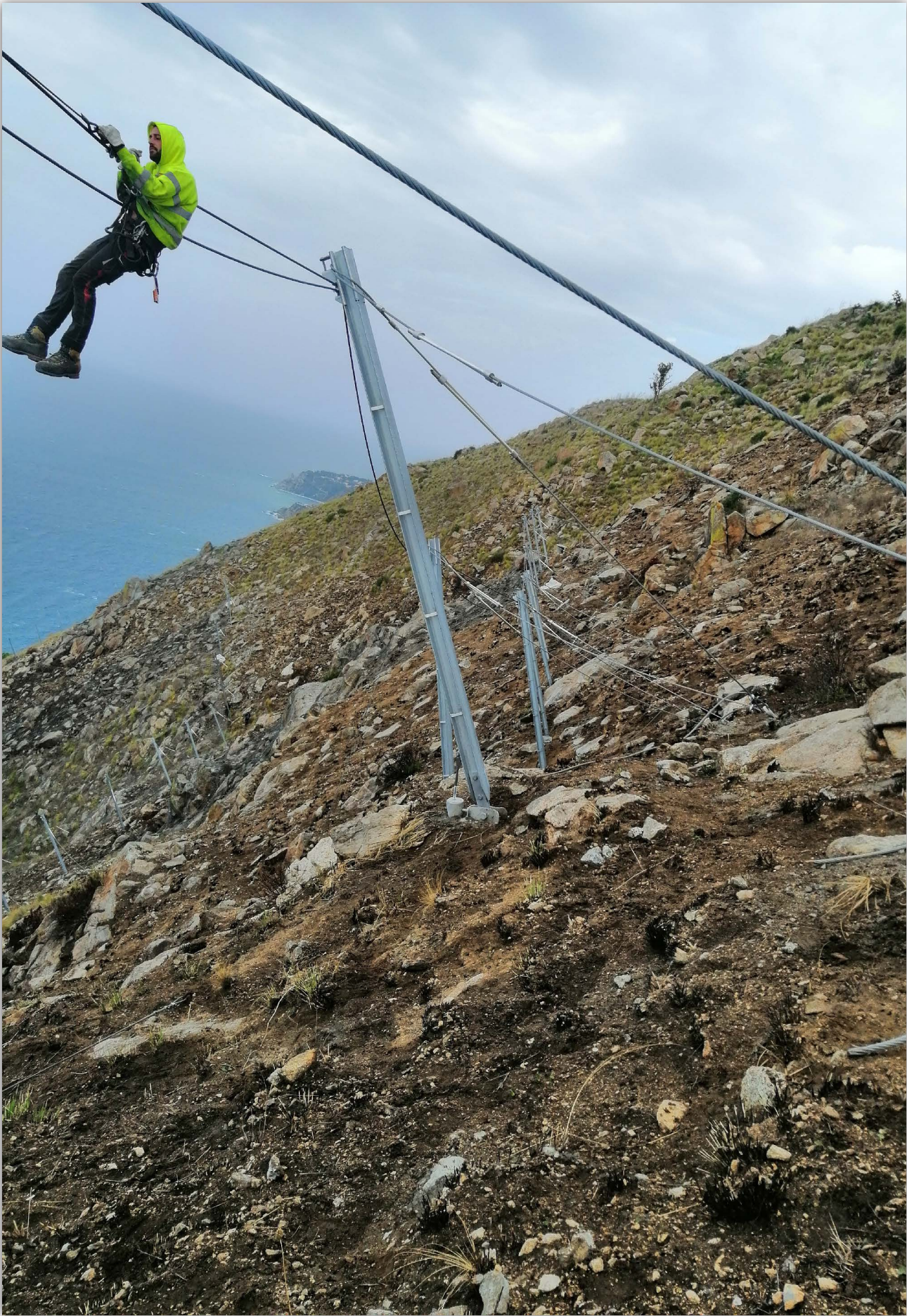
Barriere paramassi, fermaneve e simili ANAS Viabilità - SP23
