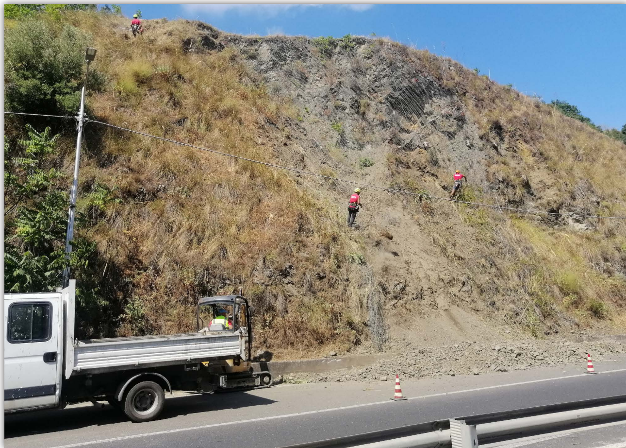
Barriere paramassi, fermaneive e simili Comune di Catanzaro - Viale Vincenzo De Filippis
