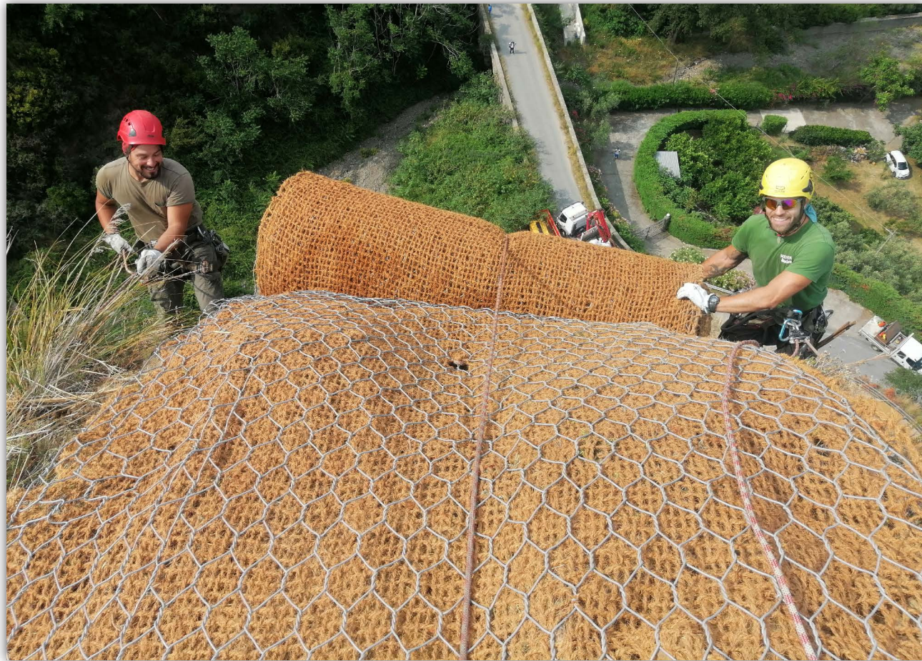
Barriere paramassi, fermaneve e simili Provincia di Vibo Valentia - Cantiere Joppolo
