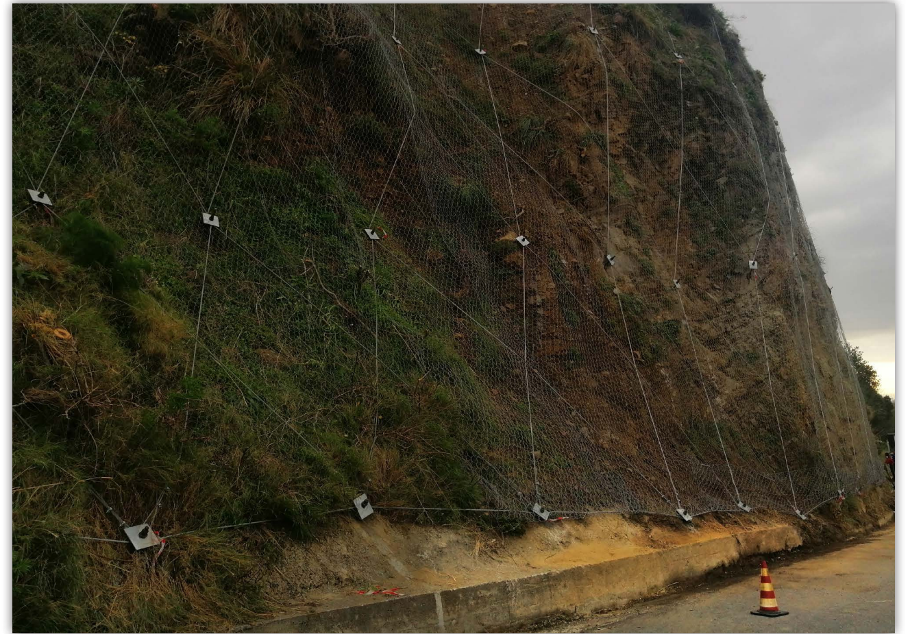
Barriere paramassi, fermaneve e simili ANAS Viabilità - NSA 571 ex SP2 Reggio Calabria
