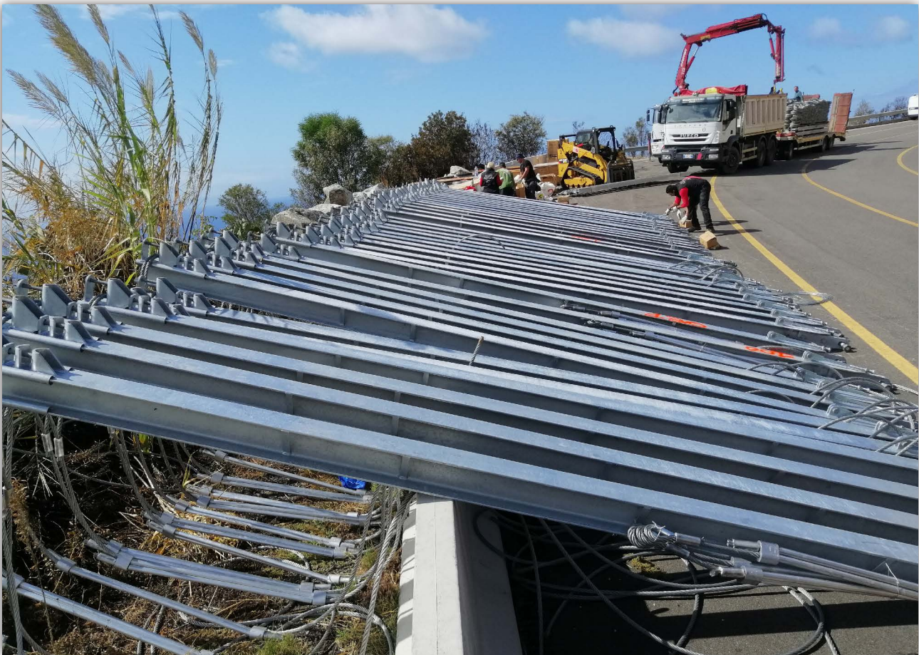
Barriere paramassi, fermaneve e simili ANAS Viabilità - SP23
